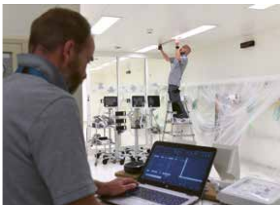
Dans les coulisses, le service technique s'assure de la sécurité de la prise en charge par un contrôle régulier des infrastructures.
